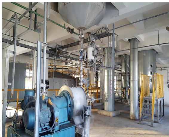
含汞废水处理装置（双效蒸发）
