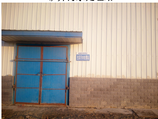
生活污水处理站
