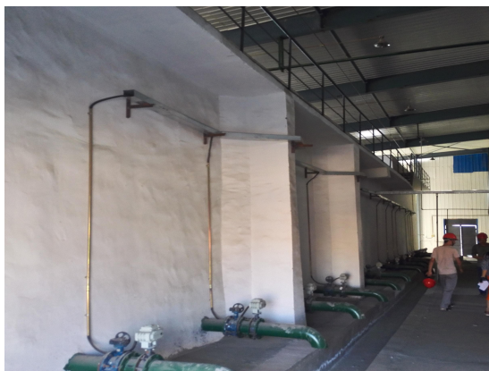
矿井污水处理设施
