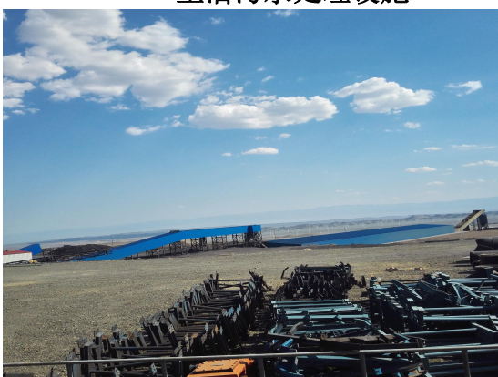
封闭式运输廊道及储煤地仓
