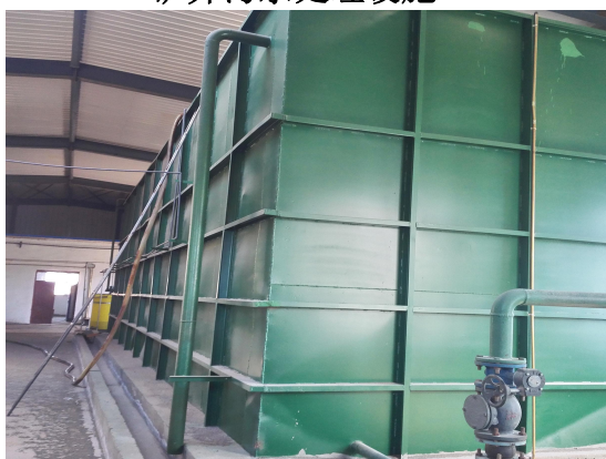
生活污水处理设施
